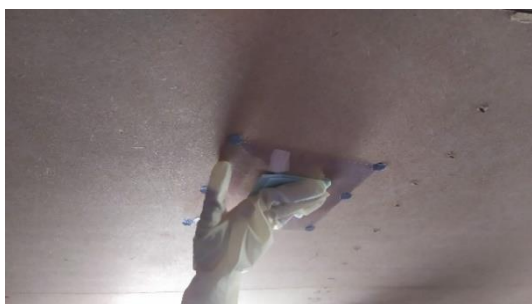
Obr. 4.4 – Stěr uprostřed záklopu
