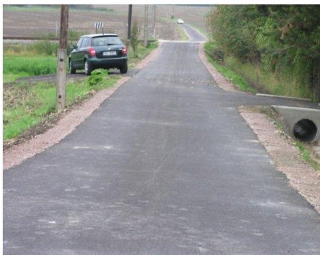
Obr. č. 8 - Vedlejší polní cesta, asfaltobetonový povrch, zpevněná krajnice a propustek (Katalog SZPÚ, 2010)
