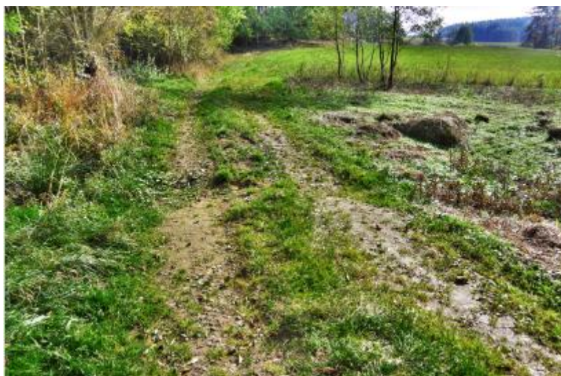
Obr. č. 40 - Poškozený propustek a zarostlý vjezd do lesa SVPC 4.
