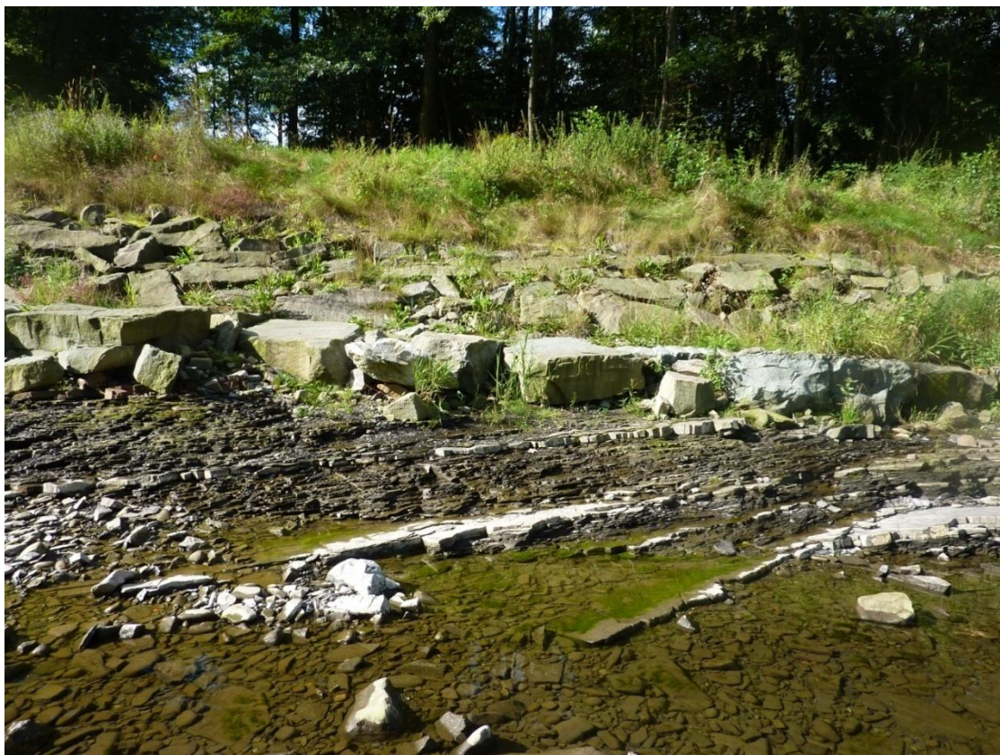
Obr. 4.21 Výmol dna a poškozené opevnění paty svahu [14]
