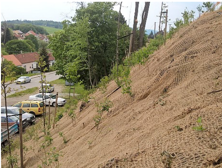
Obrázek 11 - Protierozní ochrana kokosová geotextilie (Geomat, 2023)
