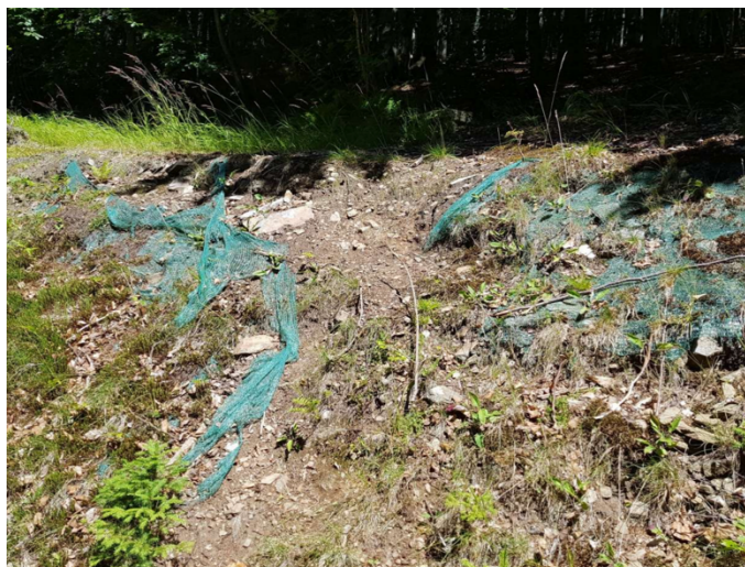
Obrázek 9 - Špatně provedená instalace na povrch svahu (Podnikelský, Grepl, 2022)
