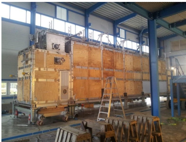
Obrázek č. 8 Fotografie z procesu stavby sušárny na ČOV v Karlových Varech ( www.stavbykarlovarska.cz )
