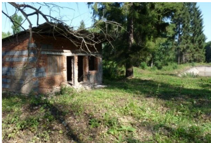
Obrázek 14 Zchátralá stavba v místě dnešního rybníku, nefunkční bazén v pozadí (foto J. Koutný)
