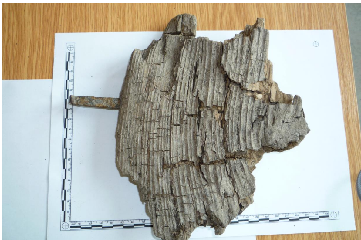
Obr. 10 Foto dřevěného trámu se zatlučeným hřebem
