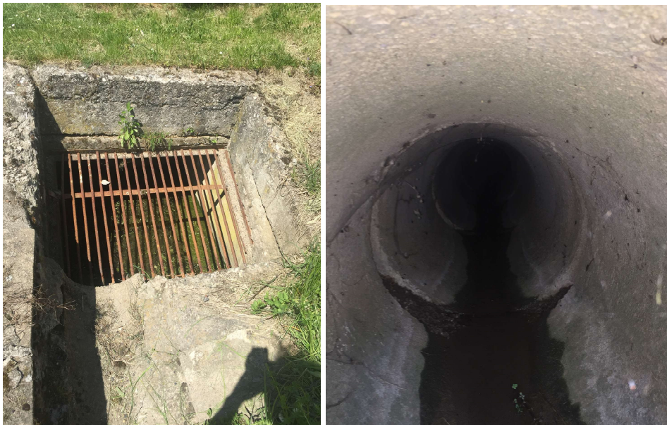
Obr. 4.4 Technický stav stoky C
