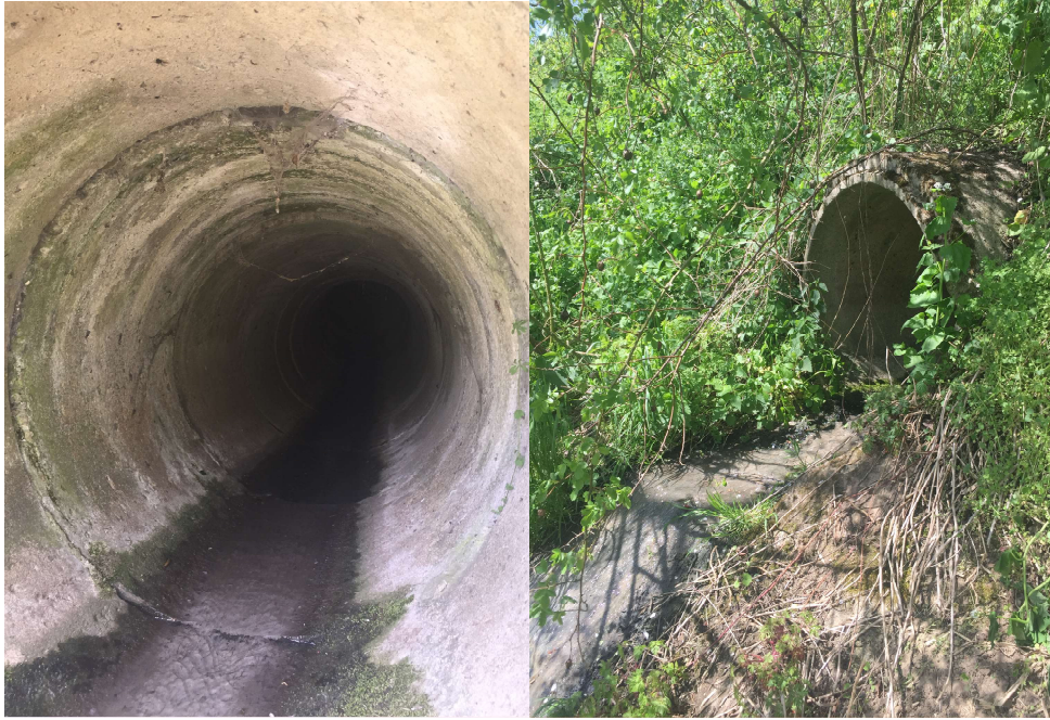
Obr. 4.3 Technický stav stoky B
