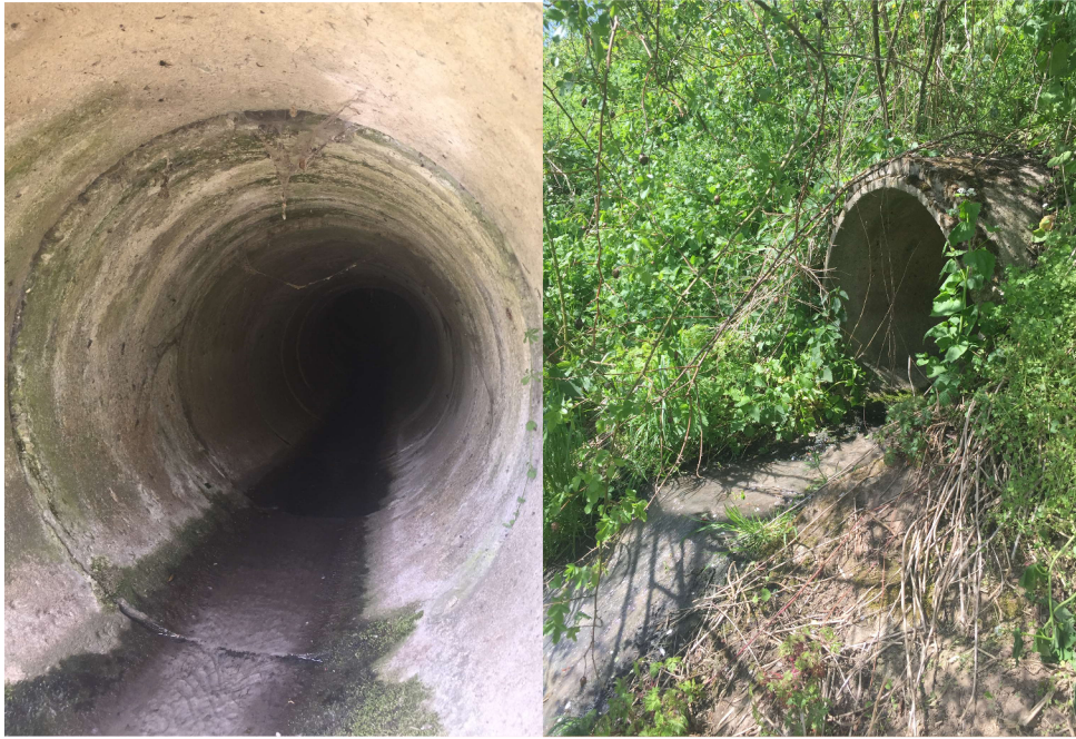
Obr. 4.3 Technický stav stoky B
