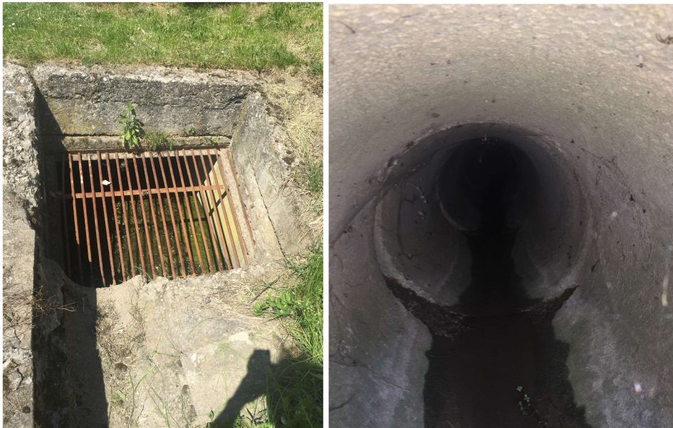
Obr. 4.4 Technický stav stoky C
