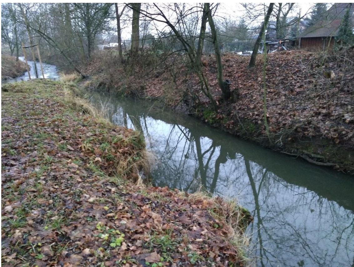
Foto. č. 2: Značně patrná eroze na mlýnském náhonu v Uničově, před soutokem s Oskavou na střelnici (Uničov, 2018)
