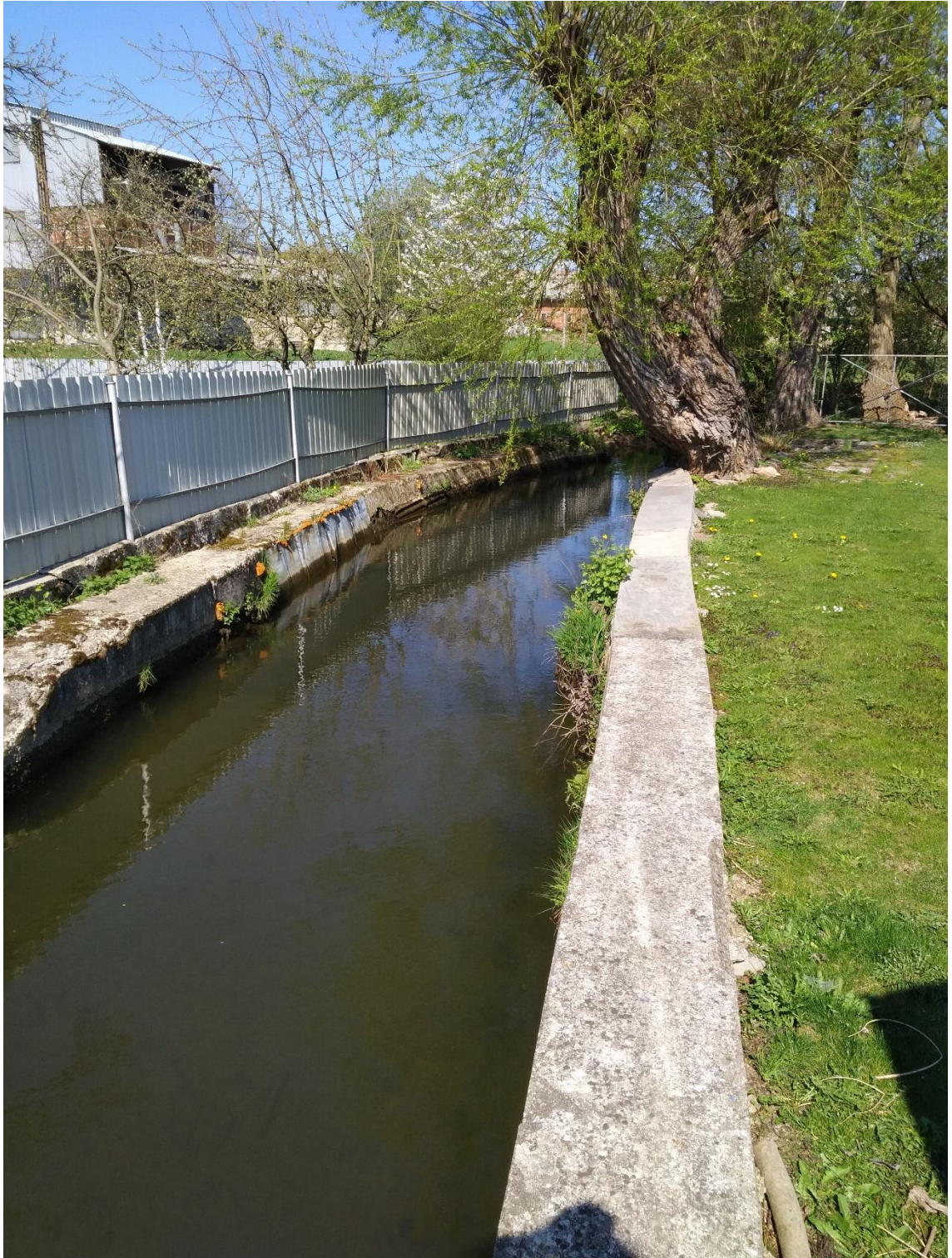
Přil. č. 35: Technický stav stěn náhonu odpovídá jeho stáří, kvalitní beton však stále odolává (Nová Hradečná, 2019)
