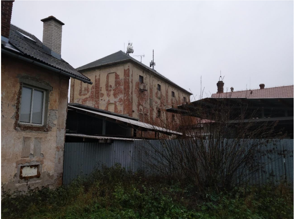
Foto. č. 14: Hlavní objekt ze zadní příjezdové cesty, vpravo větší komín jako pozůstatek po parním stroji (Dolní Libina, 2019)
