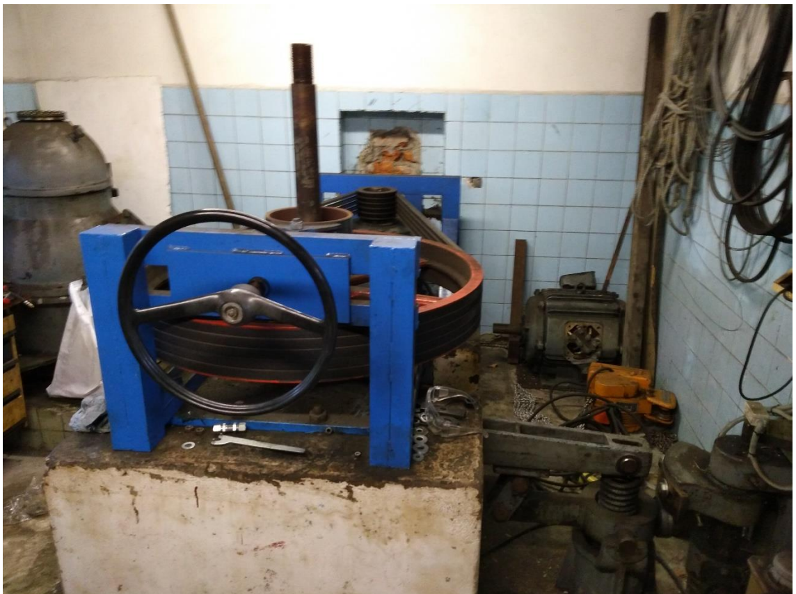
Foto. č. 22: Horní část soustrojí Kaplanovy turbíny s brzdou na soustrojí č. 1 (Pňovice, 2019)
