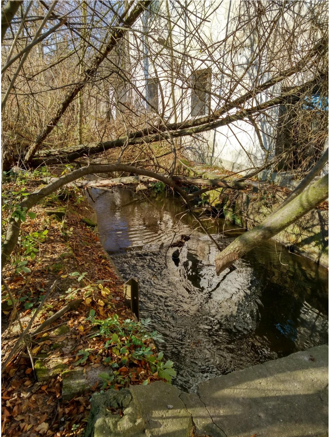
Příl. č. 52: Náhon v této lokalitě je silně neudržován a zanesen (Uničov, 2019)
