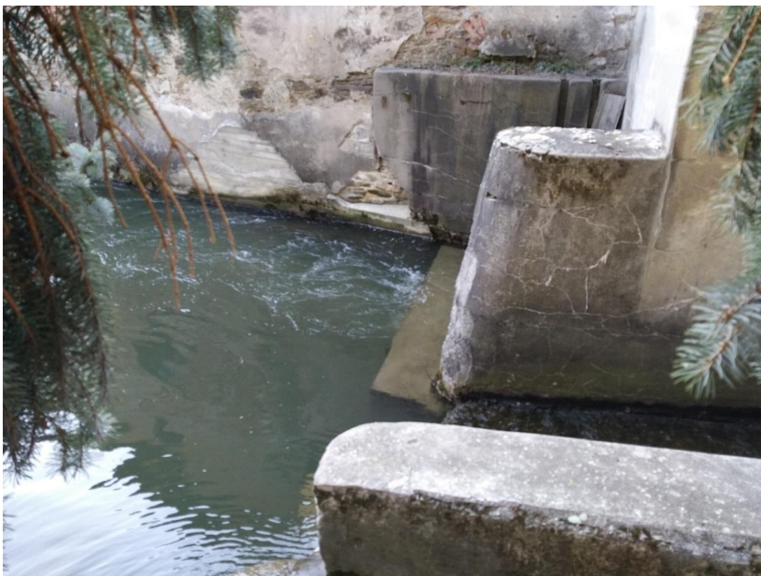
Příl. č. 56: Výtok od soustrojí elektrárny za nižšího stavu vody (Štěpánov-Liboš, 2019)
