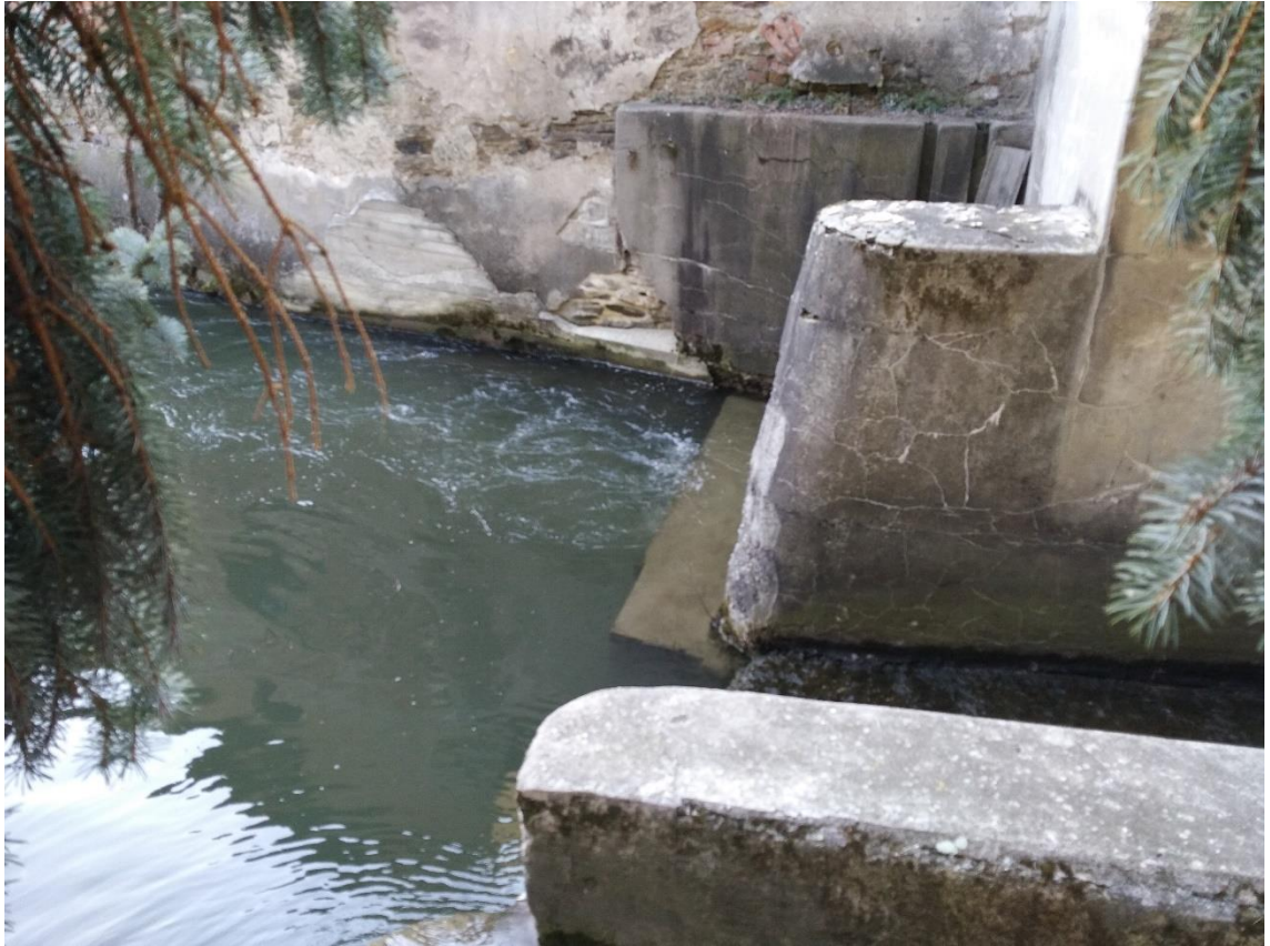
Příl. č. 88: Výtok od soustrojí elektrárny za nižšího stavu vody (Štěpánov-Liboš, 2019)
