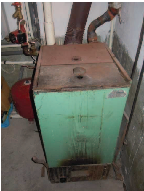
Obr. 2 – Teplovodní kotel DS 20
