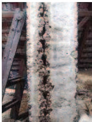
Obr. 20: Prasklý komín na půdě [26]
