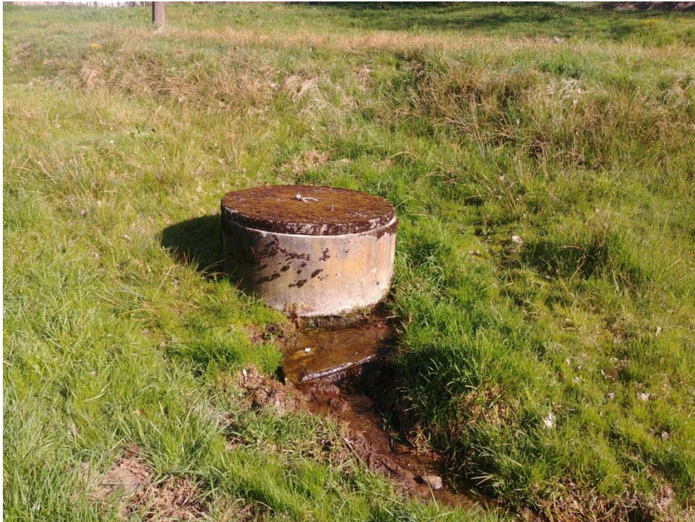
Foto č. 3: Kopaná studna ST-3
