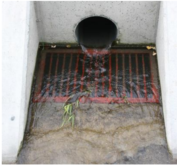
Obrázek č. 31: Usazovací nádrž u propustek znemožňuje bezpečný podchod pod silnicí (Poledníková et al. 2017a)
