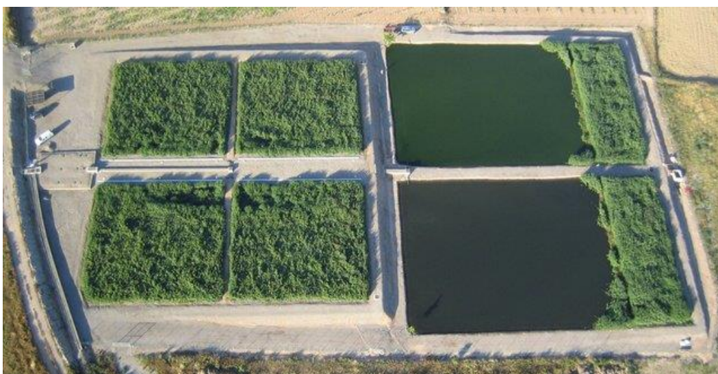
Obr. 3: Systém pro čištění odpadních vod sestávající ze tří usazovacích nádrží, čtyř mokřadů s horizontálním tokem a dvou mokřadů s vertikálním podpovrchovým tokem, (Samsó, 2014)
