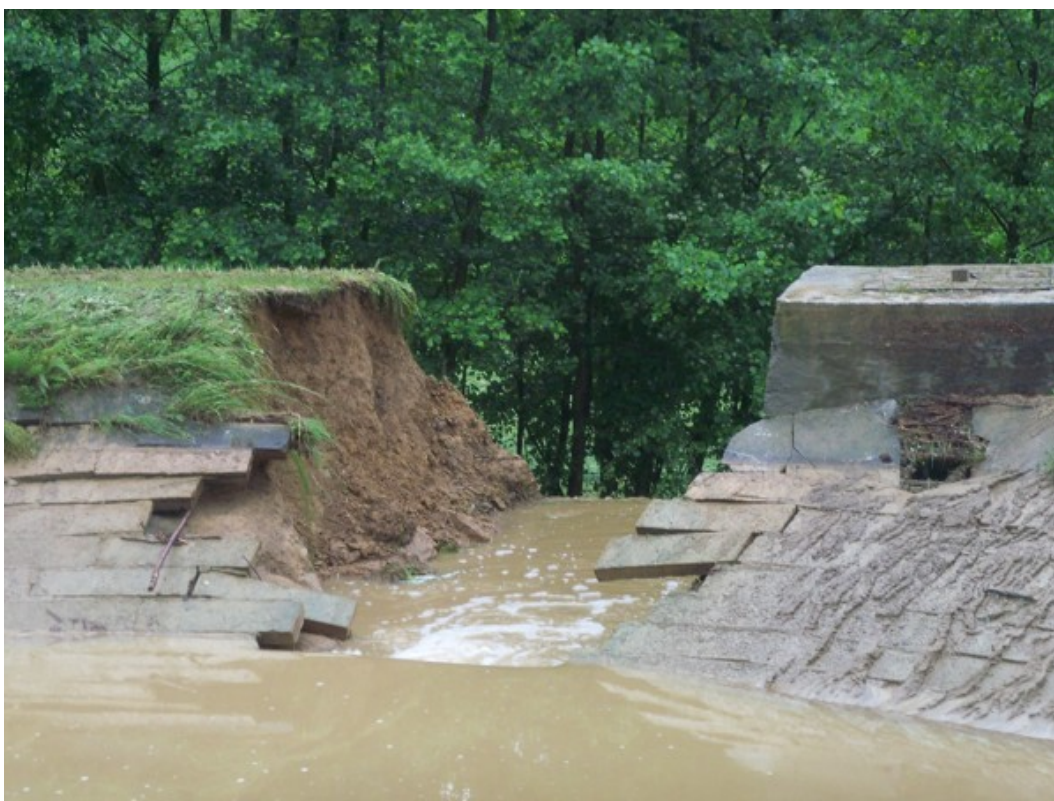
Obrázek č. 2 Protrhlá hráz rybníka nad obcí Komňa (Miloš Kafka, 2013)
