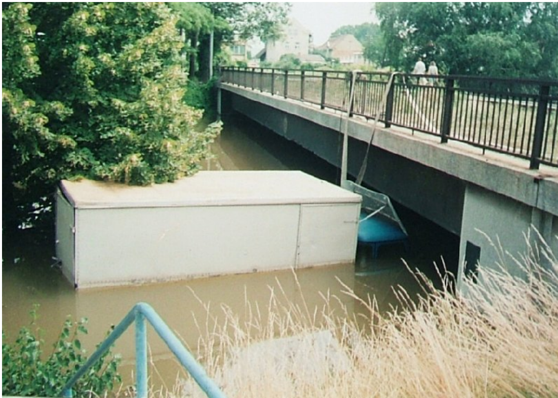
Obrázek č. 3 Zatopení silnice směrem na Uherské Hradiště (SDH Kunovice)
