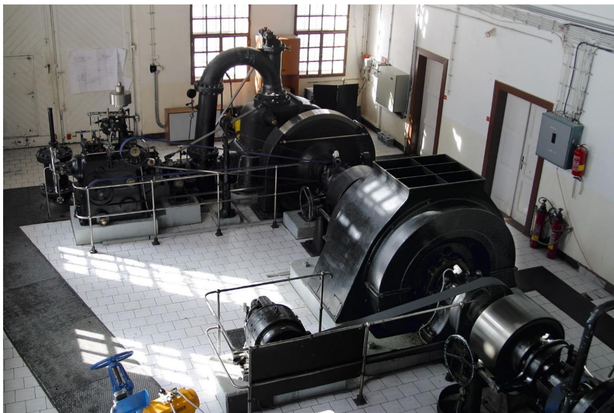
Obrázek 1.9 elektrárna Černé jezero [15]
