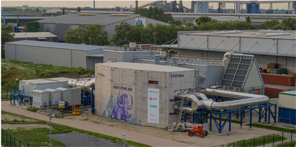
Obr. 13 Tepelné úložiště společnosti Siemens v Hamburku [43]
