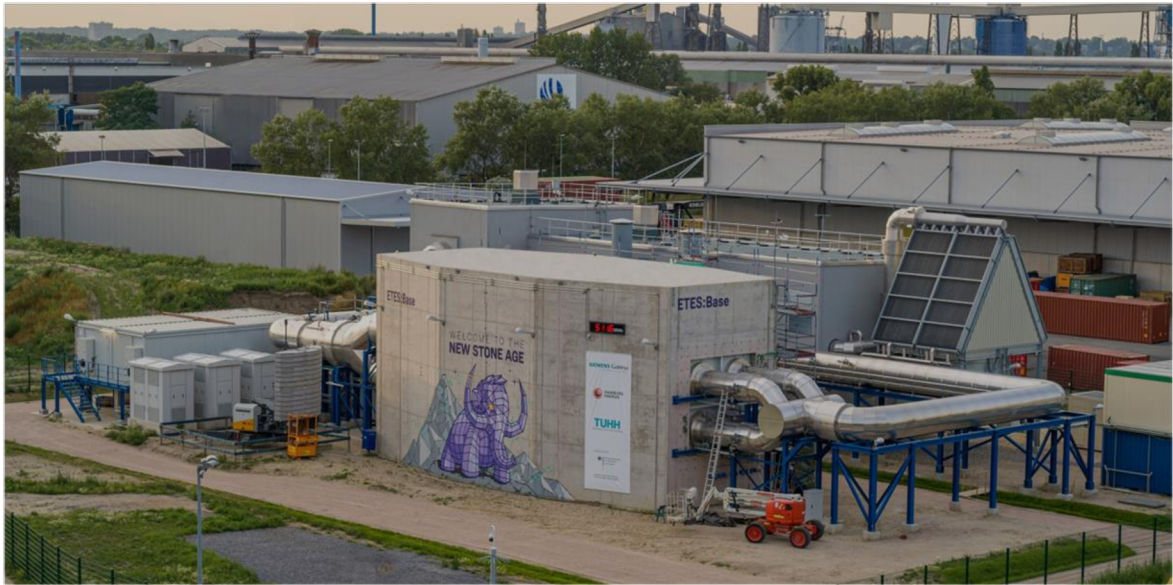
Obr. 13 Tepelné úložiště společnosti Siemens v Hamburku [43]
