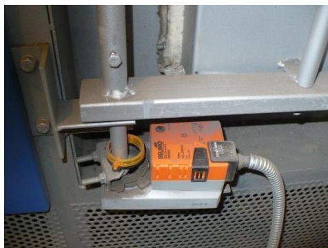
Fotografie č. 6 – Servomotor, který zajišťuje otevírání klapky při chladnutí
