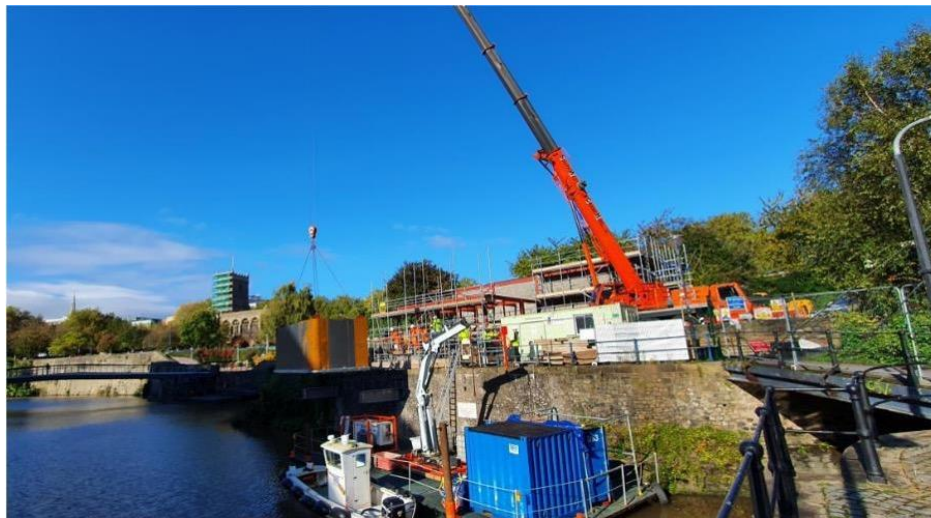
Obr. 6 Instalace tepelného čerpadla v Bristolu [6]
