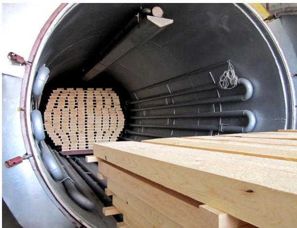
Obr. 3. Uložiště pro TMD, vnitřní pohled. Zdroj: ( www.lesprominform.ru ), 2013
