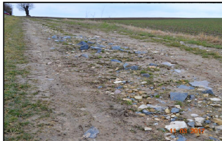
Obr. 6 - poškozená cesta do Šafranic vlivem vymílání povrchovým odtokem
