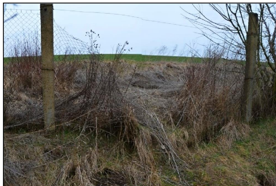
Obr. 8 - Místo nad svahem, kudy protéká voda dovnitř při průtržích
