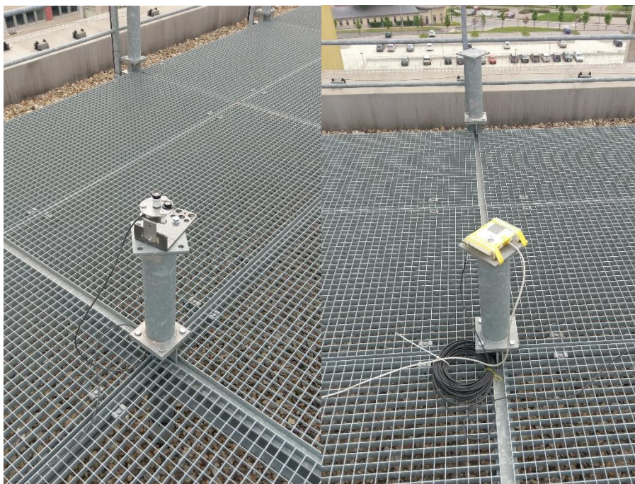
Obr. 8.21 Umístění snímačů na střeše ústavu elektroenergetiky (detail)
