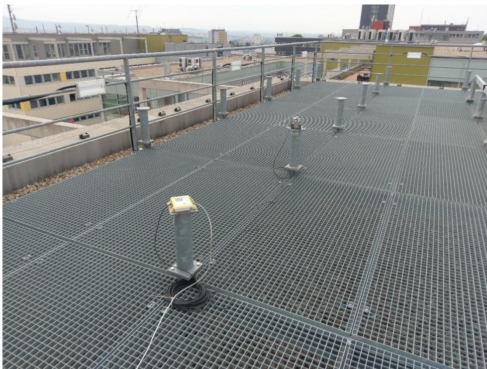
Obr. 8.22 Umístění snímačů na střeše ústavu elektroenergetiky
