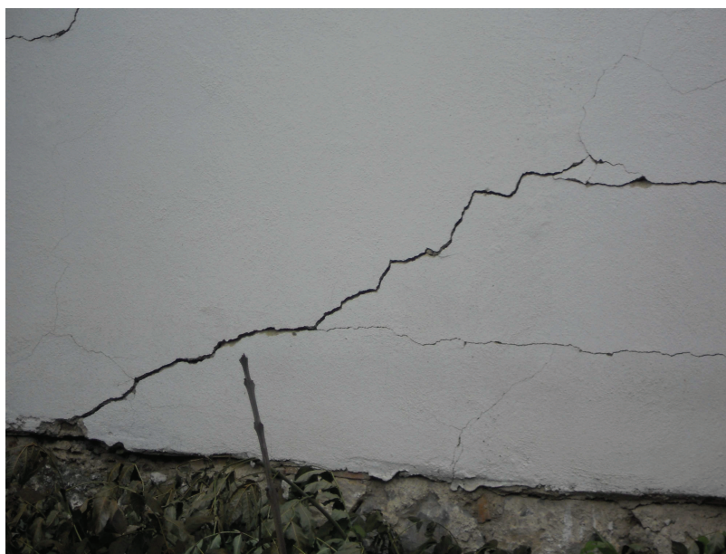
Obr. 8: Detail trhliny ve štítové zdi.
