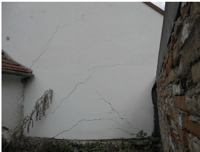
Obr. 7: Trhliny ve štítové zdi.
