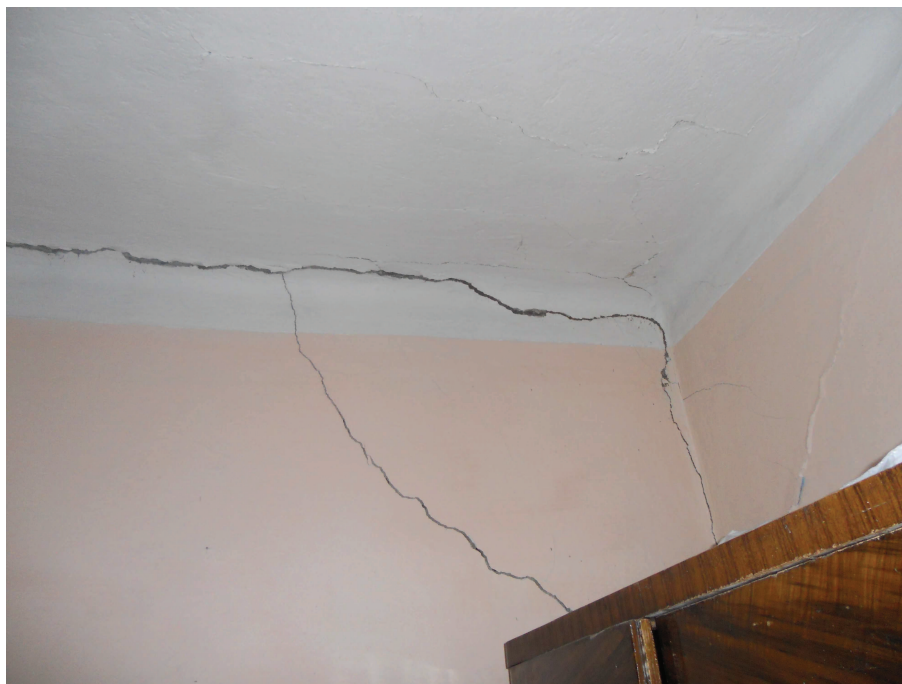
Obr.8: Trhlina na vnitřní straně průčelní zdi.
