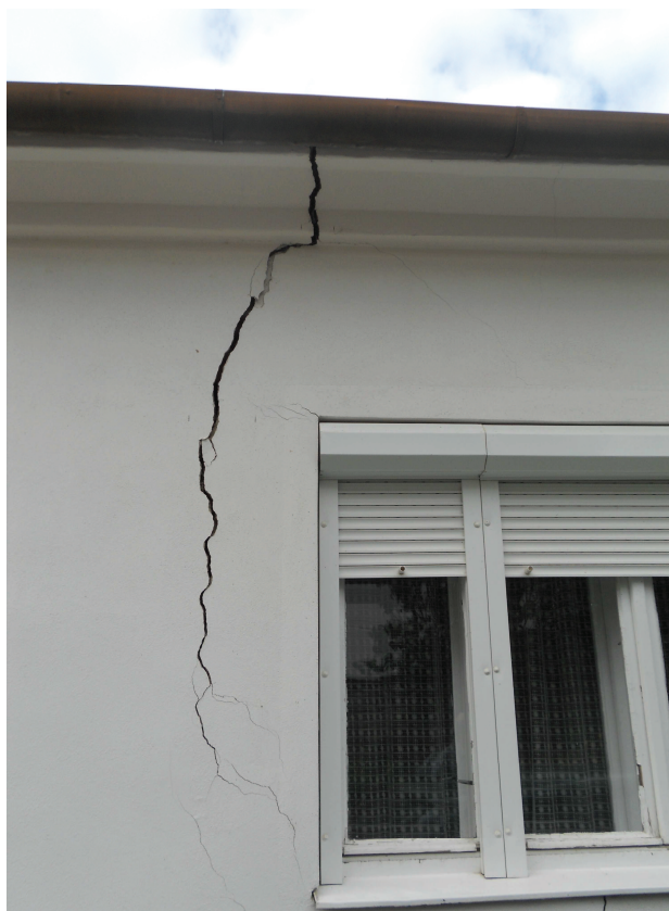
Obr. 6: Trhlina v průčelní zdi.
