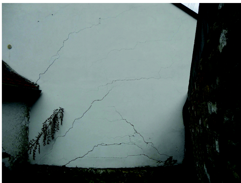
Obr. 7: Trhliny ve štítové zdi.
