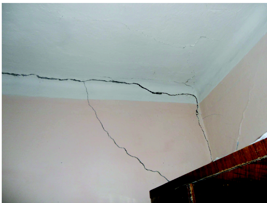
Obr.8: Trhlina na vnitřní straně průčelní zdi.
