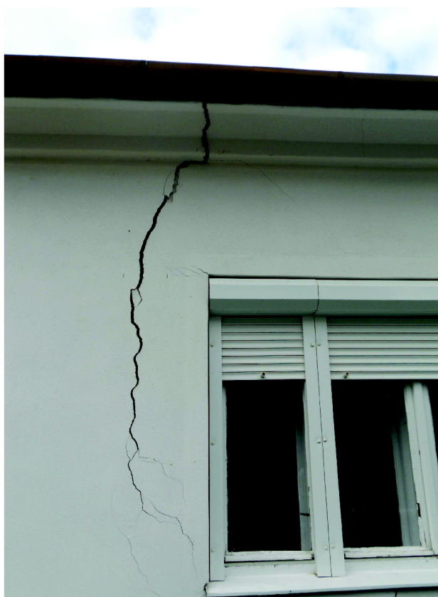
Obr. 6: Trhlina v průčelní zdi.
