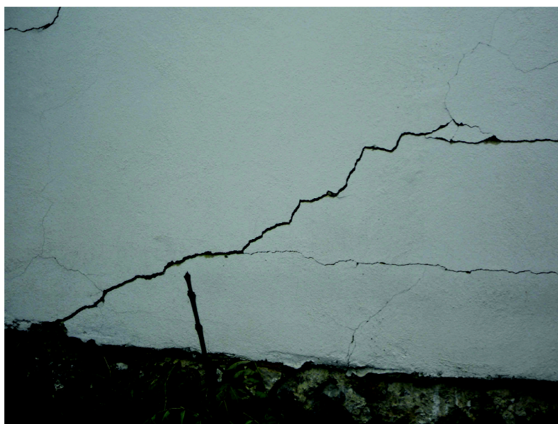
Obr. 8: Detail trhliny ve štítové zdi.
