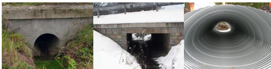
Obr. 25: Příklad trubního (vlevo), rámového (uprostřed) propustku (Anděl et al., 2011) a tlamového (vpravo) propustku ( www.uskk.cz )
