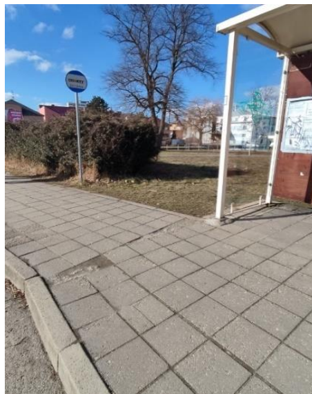
Obrázek č. 20 - Absence hmatových prvků a návazností na plochách zastávek BUS
