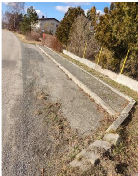
Obrázek č. 34 - Absence hmatových prvků na zastávce BUS
