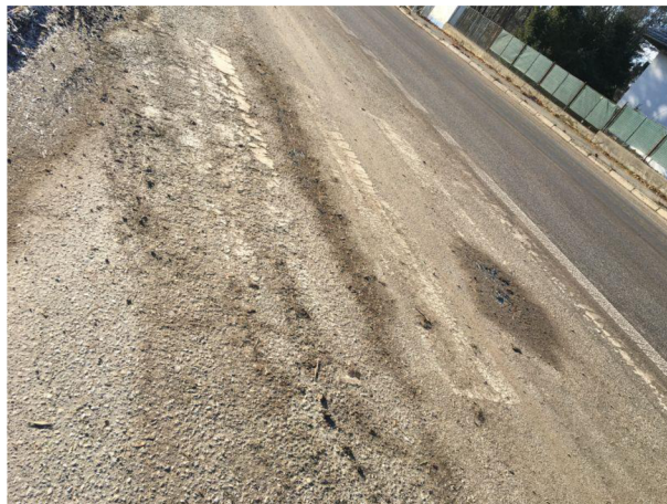
Obrázek 2 - Nevyhovující převedení cestujících přes silnici č. II/603
