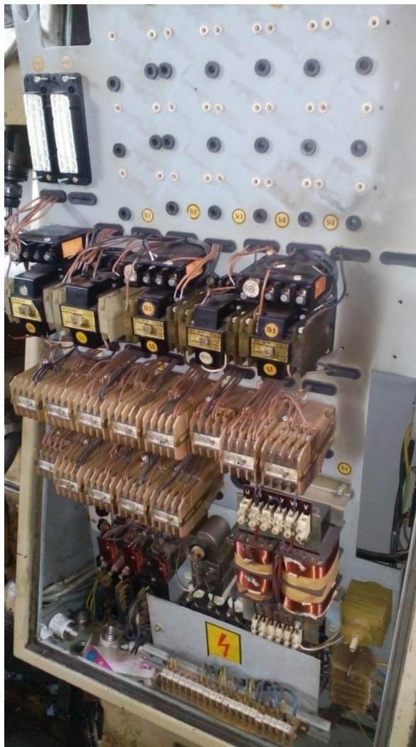
Obrázek 3: Původní elektrický rozvaděč
