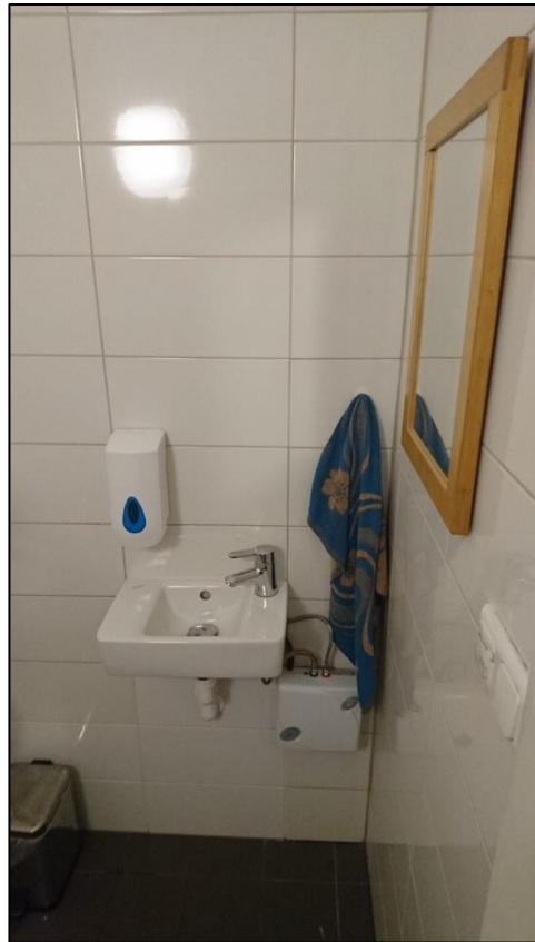
Obrázek 34. Vybavení upravené kabiny WC
