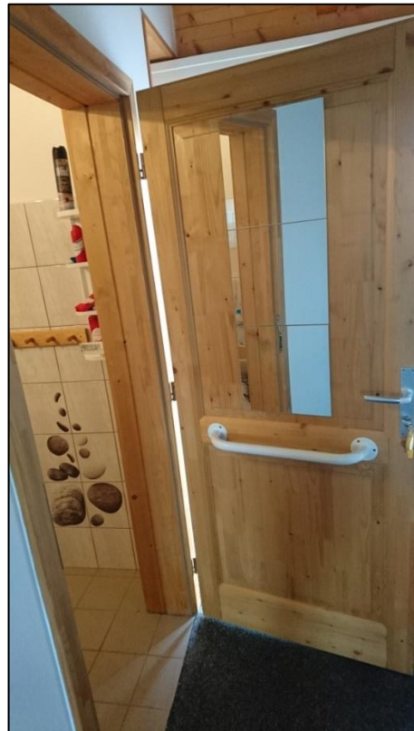
Obrázek 16. Upravený vstup na WC
