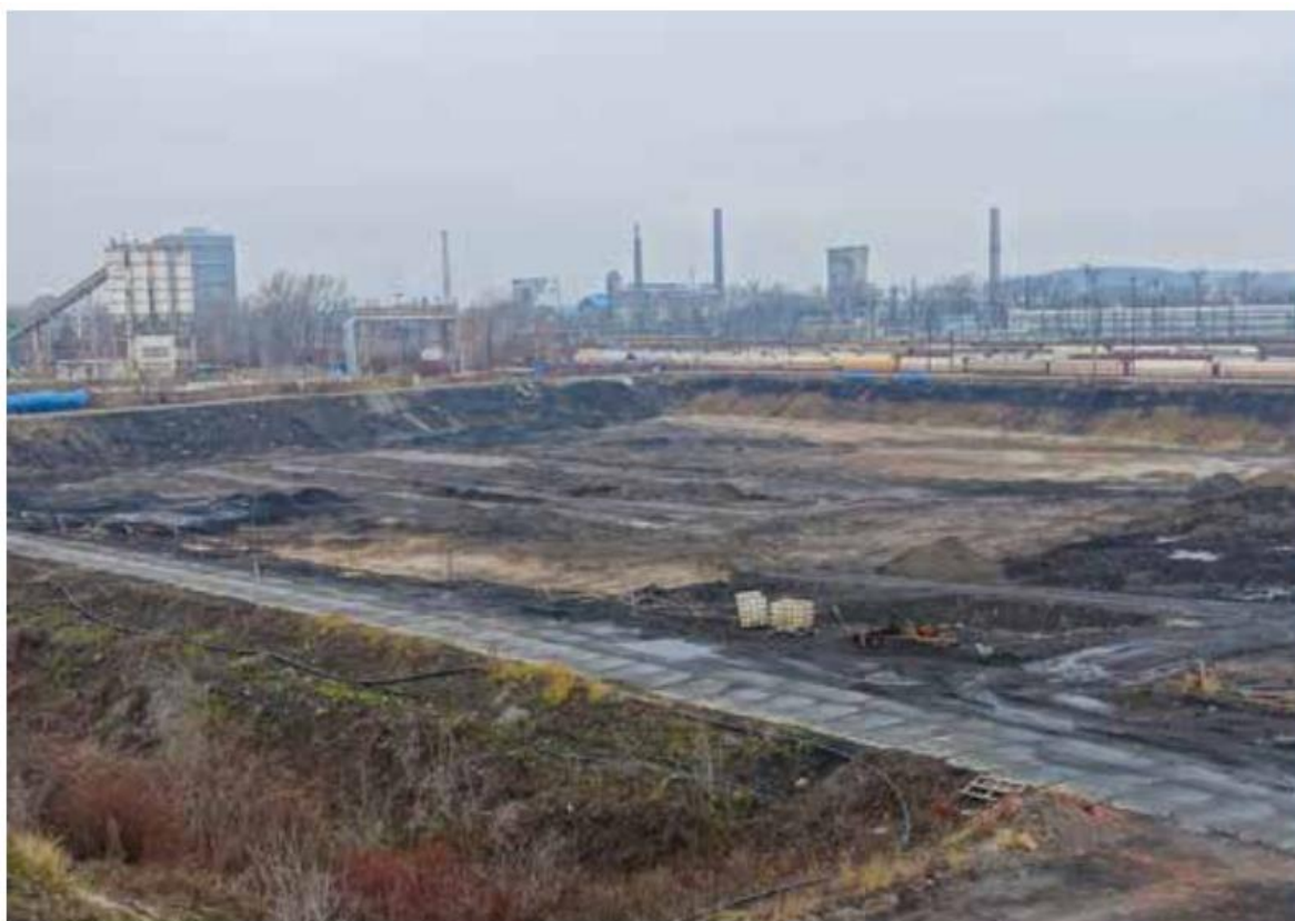
Obrázek č. 17: areál laguny Ostrava v Ostravě – rok 2022, zpracovány ropné kaly, příprava na sanaci kontaminované zeminy (zdroj: Odpadové fórum–DIAMO-rozhovor)
