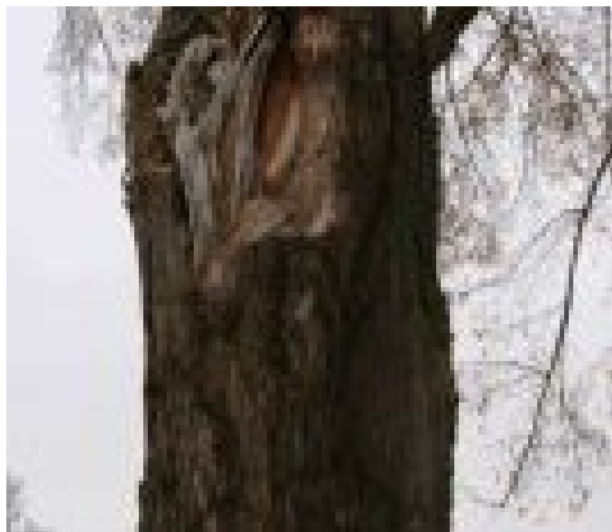
16_2323_Alej Vzdechů_Kmen - Defekt po vylomení
