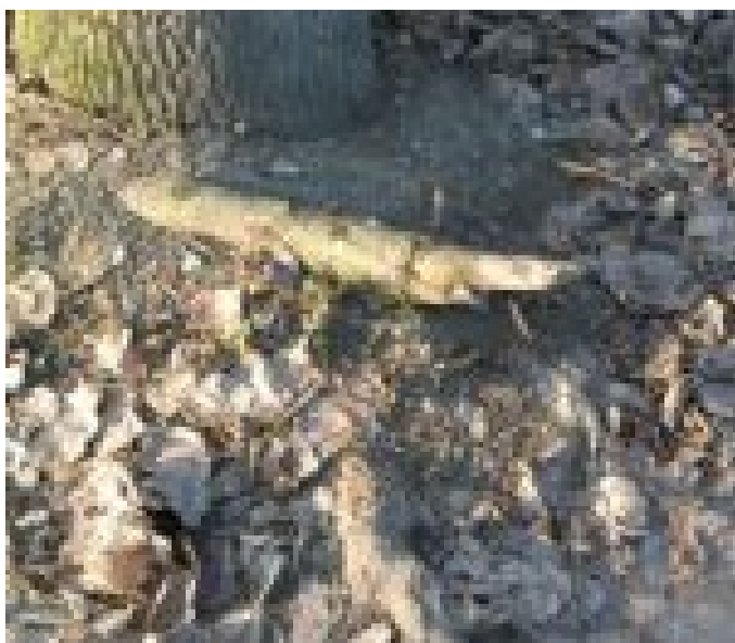
006_2364_Alej Kilometrovka_Kořenový náběh - Mechanické poškození
