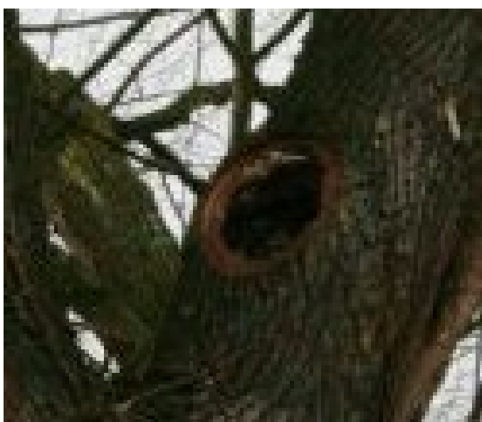
18_2355_Lípa ve Staré Huti_Řezná rána - Koruna - Průměr nad 0,10 m - Otevřená dutina
