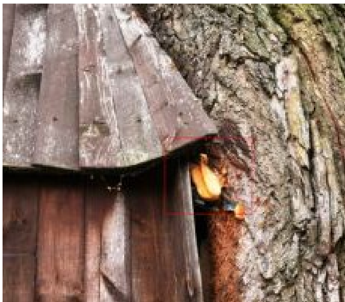
15_2360_Vrčeňská lípa_Kmen - Jihovýchodní strana - Zastřešená dutina - Prostor mezi kmenem a zast
