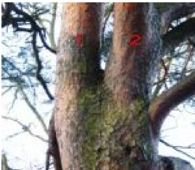
11_4721_Borovice u Košináře_Kmen - Místo primárního rozvětvení - Východní strana
