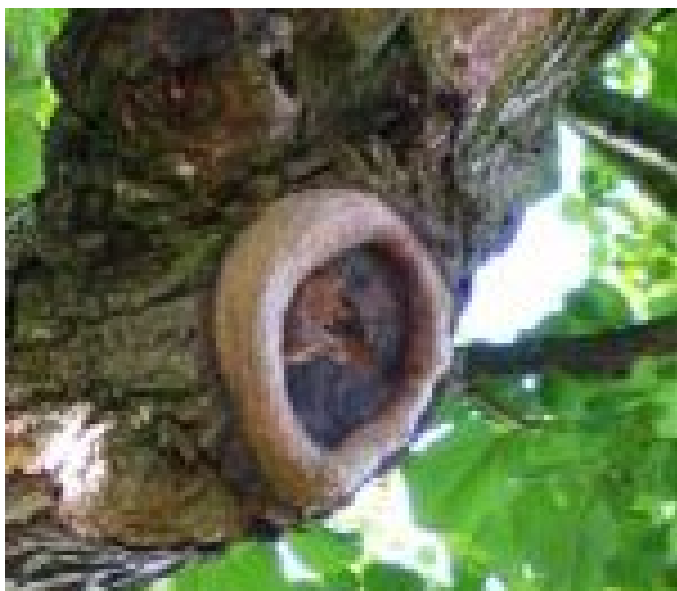
26_2344_Malinecká lípa_Řezná rána - Koruna - Provedení 1998 - Průměr nad 0,10 m - Vznikající duti
