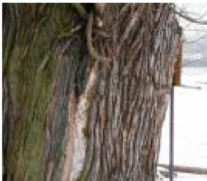
13_2357_Mlynářova lípa_Kmen - Severní strana - Odloupnutá borka v podélném pásu
