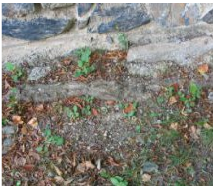
06_2336_Keslova lípa ve Střížovicích_Kořen - Západní strana - Mechanické poškození
