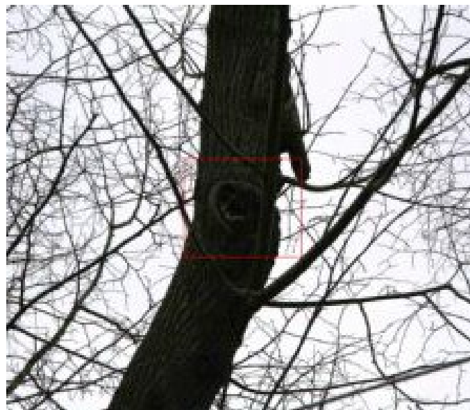
15_2355_Lípa ve Staré Huti_Řezná rána - Koruna - Průměr nad 0,10 m
