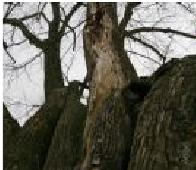
18_2356_Milečská lípa_Terciární osa - Odloupnutá borka v podélném pásu - Vznikající otevřená dutí
