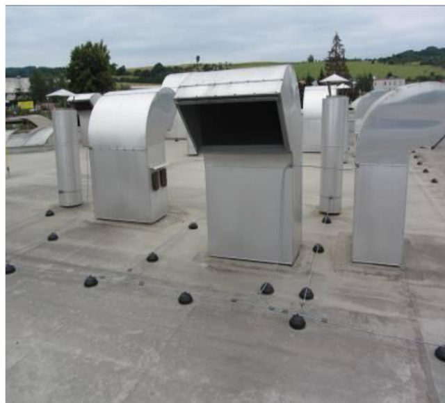
Obr. 8-8: Ukázka podobné situace se střešní vzduchotechnikou
