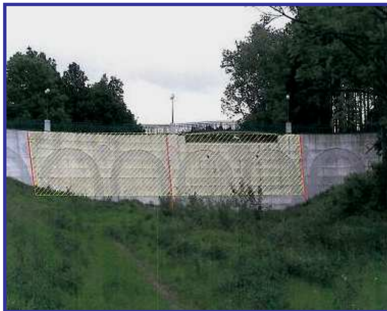
Obrázek 20: Zakreslení průlomového otvoru v tělese RN Hlinky
