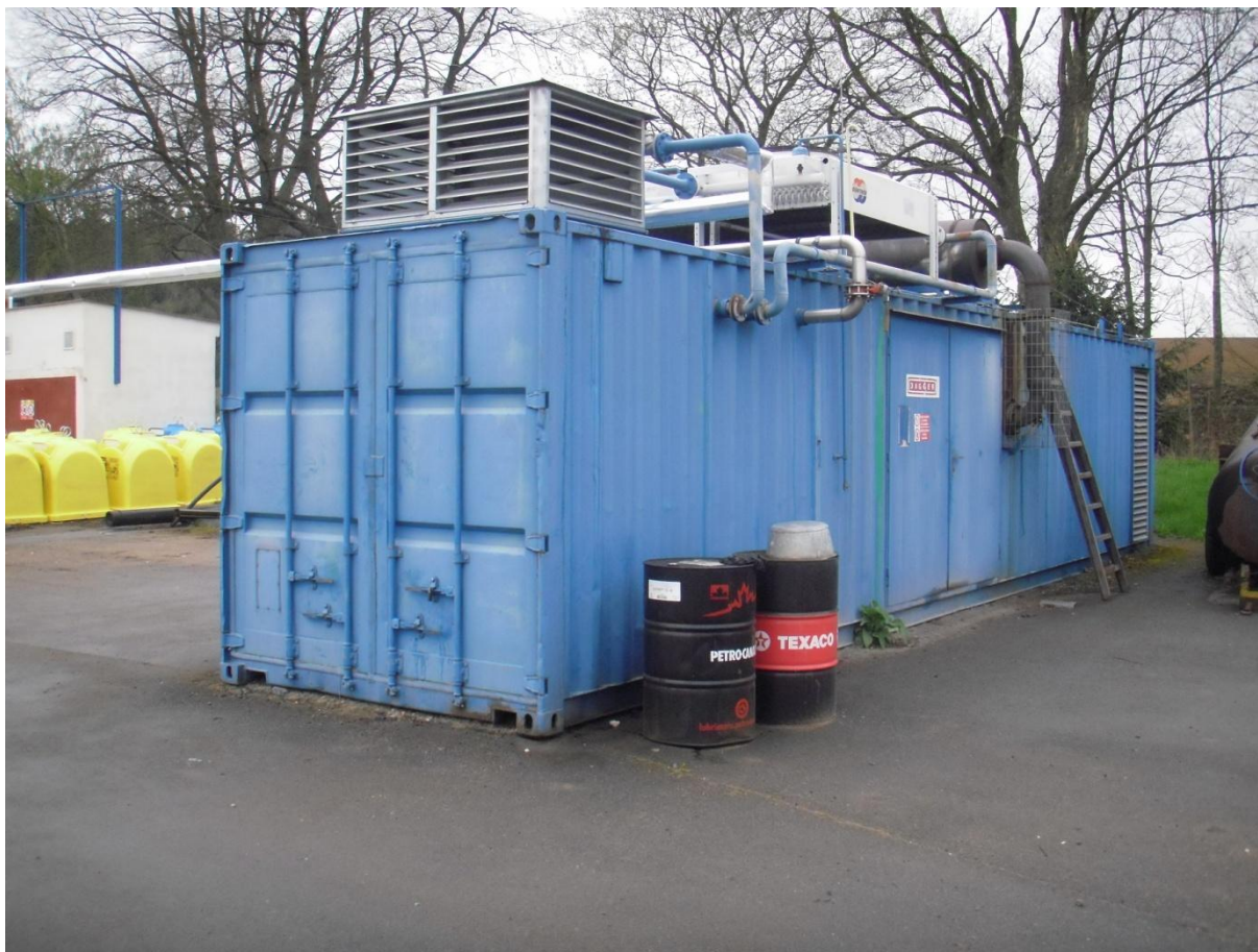
Příloha č.3: Kogenerační jednotka
