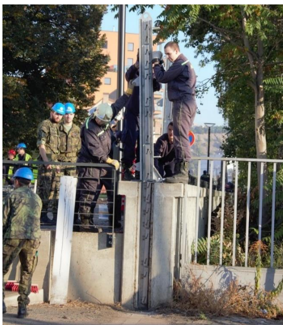
Obrázek 7: Boční vedení zabetonované do železobetonové zídky, na které navazuje slupice
