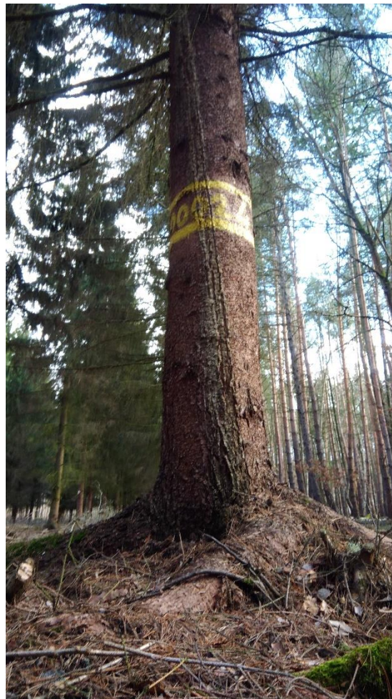
Obrázek 30: Trhlina (Foto: vlastní zdroj)
