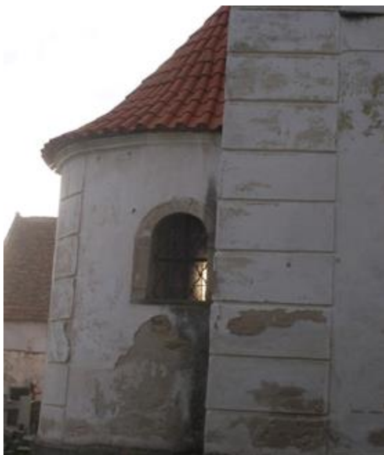
Obr. č. 17 – Kostel sv. Jiří v Blansku, apsidový závěr kaple sv. Jana Nepomuckého z východního pohledu, foto: autorka.
