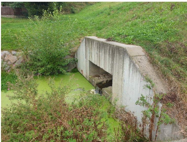
Obrázek 2.16: Výpustné zařízení - výtok (vlastní)
