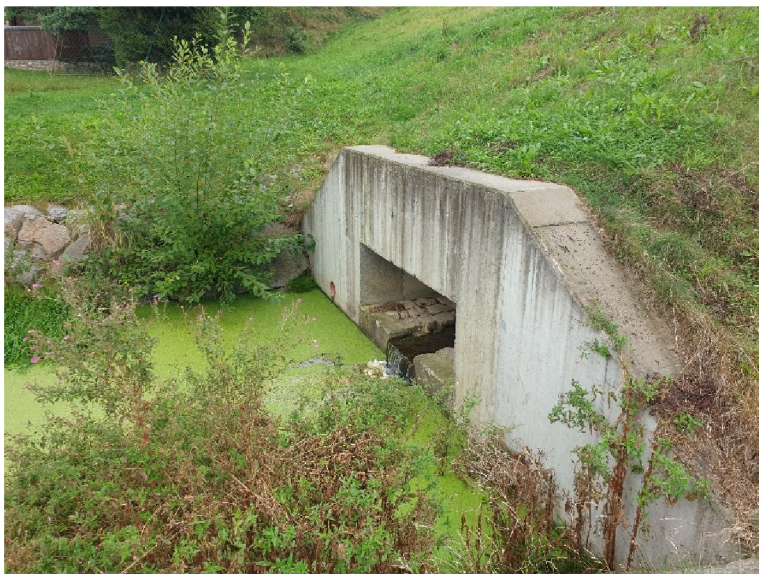
Obrázek 2.16: Výpustné zařízení - výtok (vlastní)
