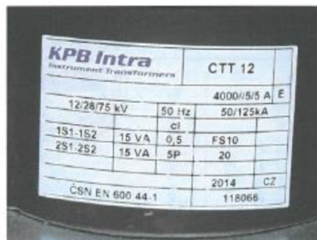
Výrobní štítek transformátoru
