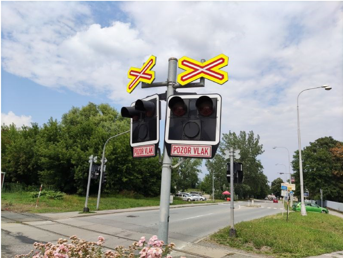
Obr. 4.9 Zdvojené světelné návěstí na ŽP P7612
