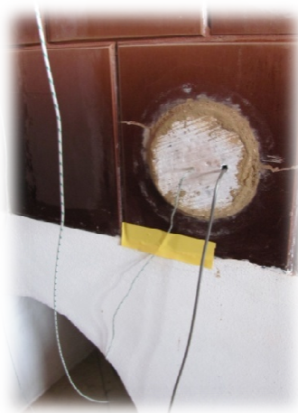
Obrázek C 14 - Umístění teplotního čidla do čistícího otvoru tahového systému.
