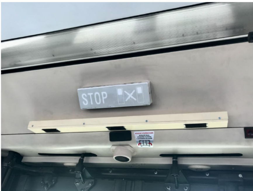
Obr. 4.1 Dveřní rám vybaven sčítacími senzory Zdroj: [1]
