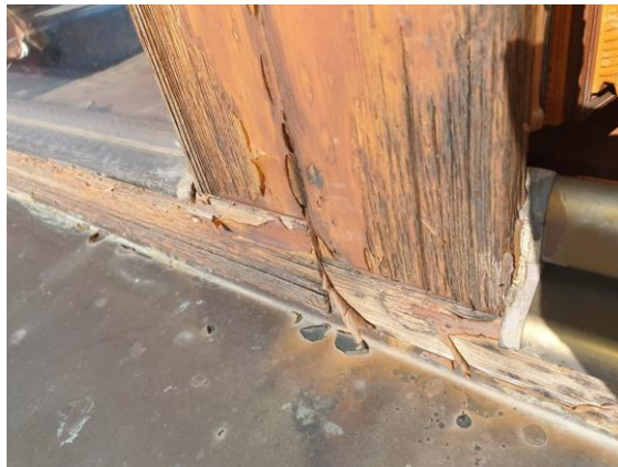
Obr. 7 Fotografie - Detail poškození hlavního rámu okna
