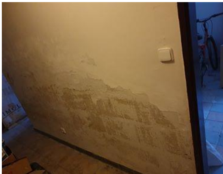
Obr. 4 Fotografie stěny napadené plísní
