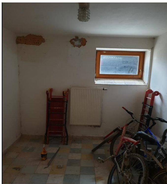
Obr. 5 Reálná fotografie sklepních prostor po aplikaci nátěru proti plísním
