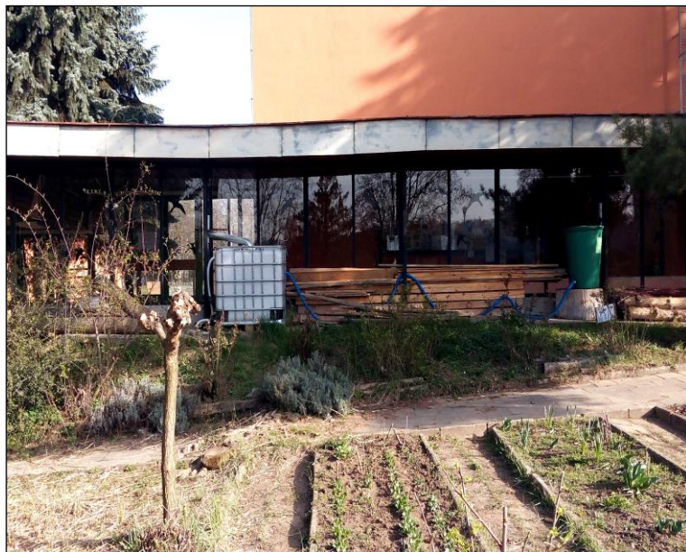
Obr. 3 Ukázka svodu dešťové vody ze střechy budovy
