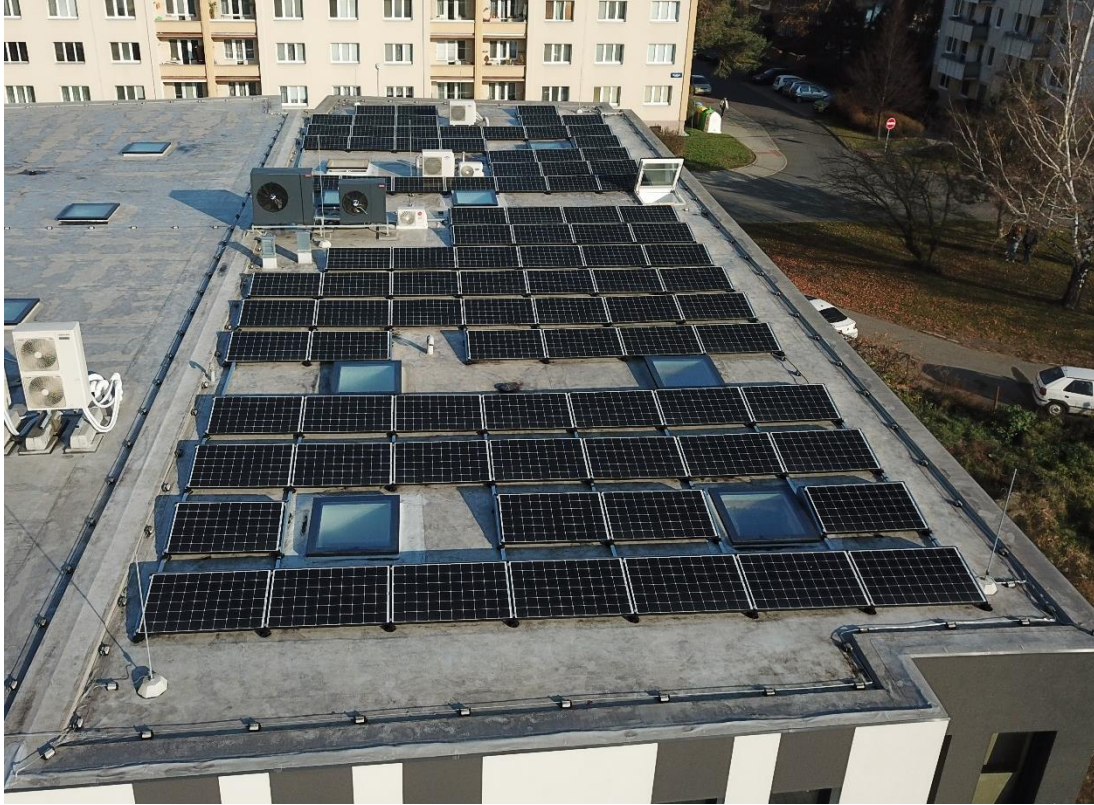
Obr. 5-1 Fotovoltaická elektrárna při pohledu shora
