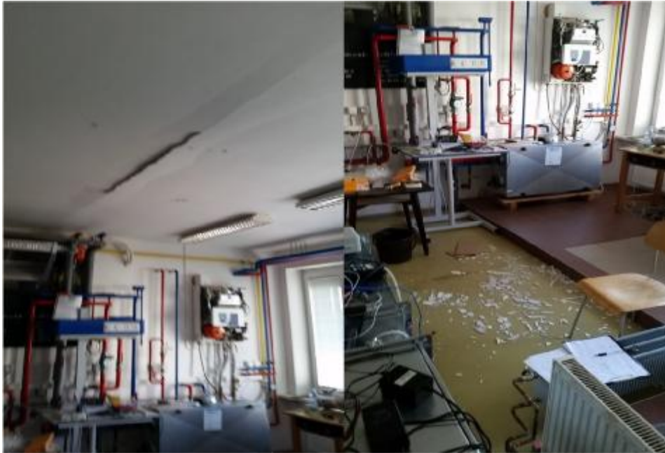
Obr. 3.36 Poškození omítky v laboratoři
