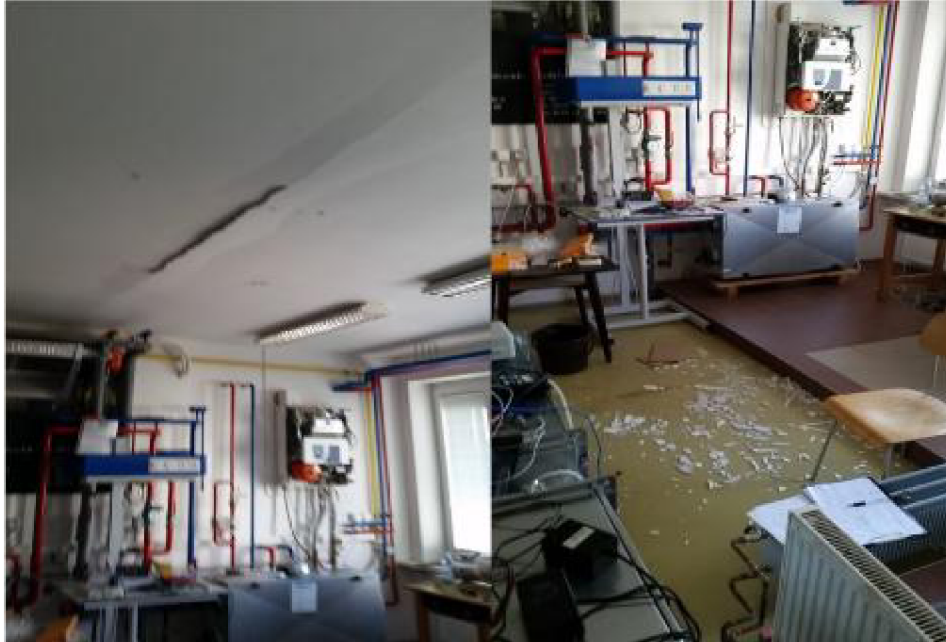
Obr. 3.36 Poškození omítky v laboratoři
