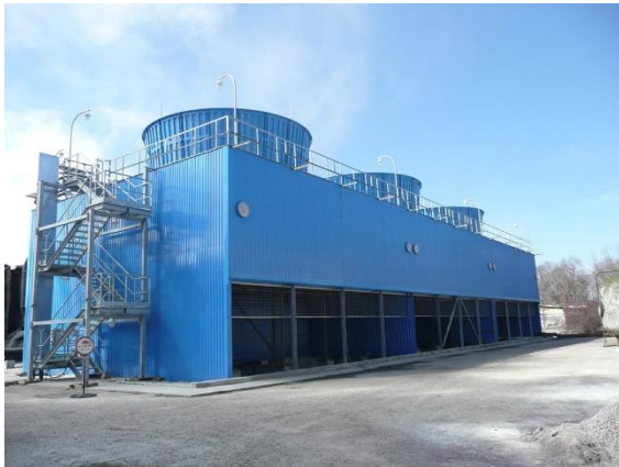
Obr. 4.1.4: Věž s horními ventilátory [e]
