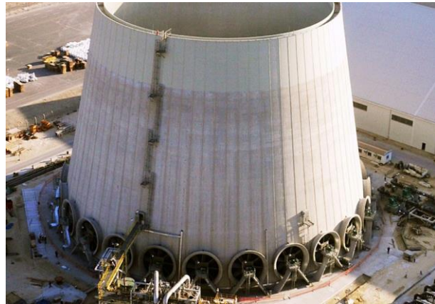
Obr. 4.1.5: Věž se spodními ventilátory [g]
